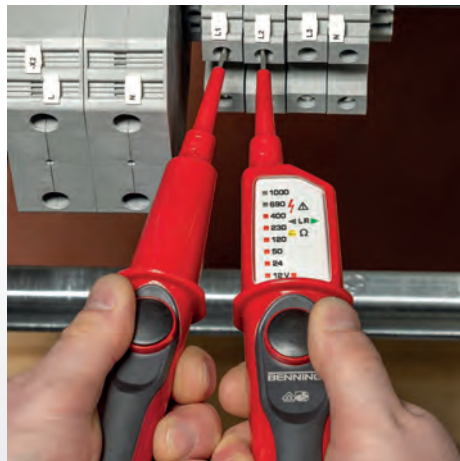
testen van het draaiveld aan de uitgangsklemmen van een UPS
