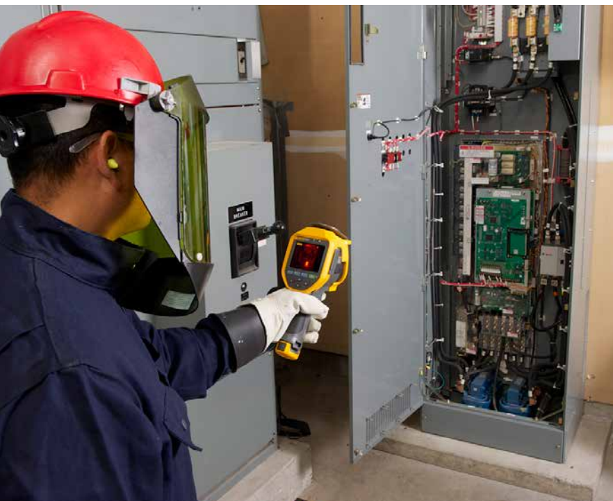
Bij het scannen van een spanningvoerende elektrische verdeler moet u geschikte persoonlijke beschermingsmiddelen (conform 70E) dragen voor vlambogen en ten minste 1,20 meter van de verdeler af staan.
